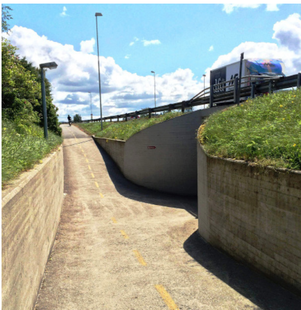
Figur 4: Gang- og sykkelveg med undergang. Uoversiktlig i alle retninger fra ut- og innside. Foto Sola kommune
